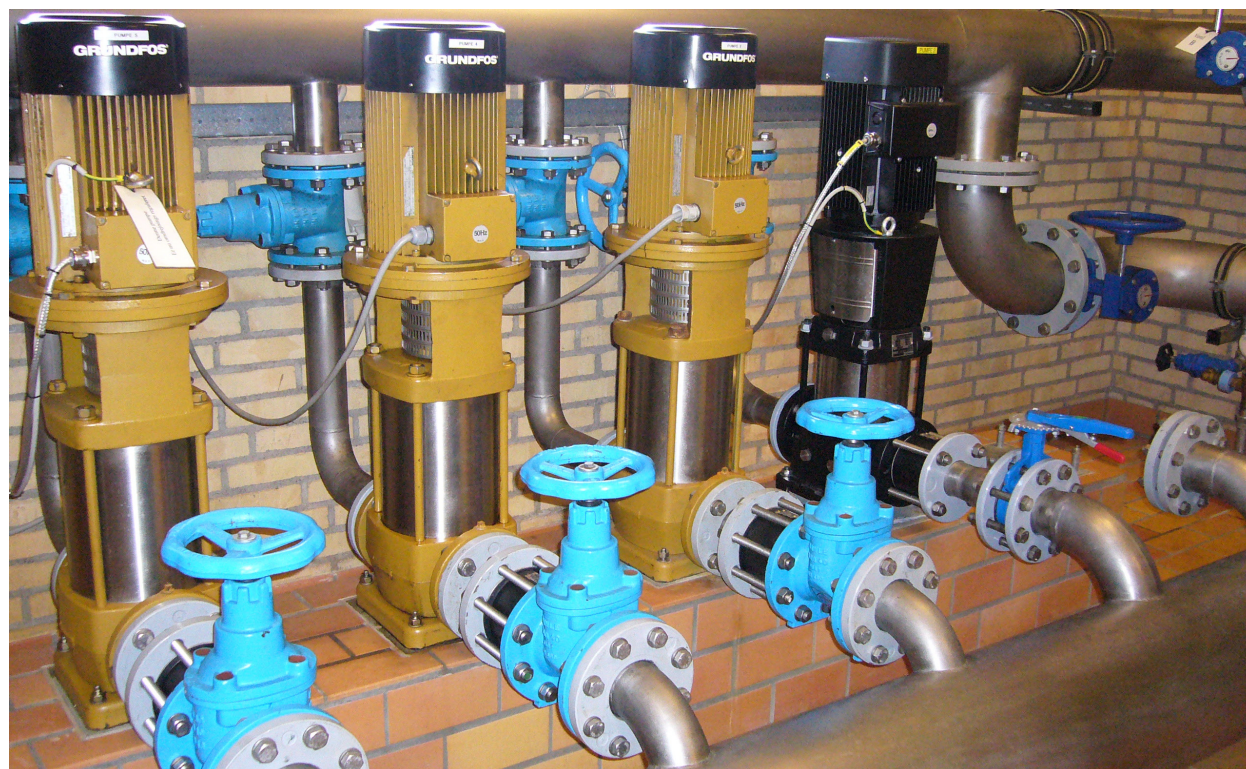
Rentvandspumper på vandværk.
