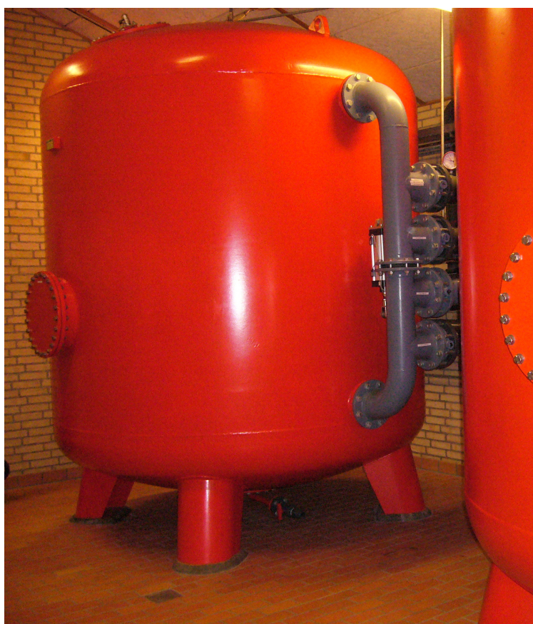
Lukket sandfilter på vandværk.
